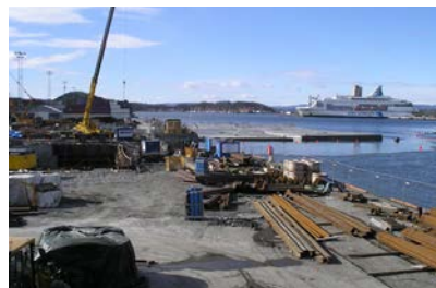
Bjørvikatunnel Oslo | Norway
